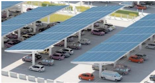
ILLUSTRATION 55. OMBRIÈRES ÉQUIPÉES DE PANNEAUX SOLAIRES PHOTOVOLTAÏQUES
